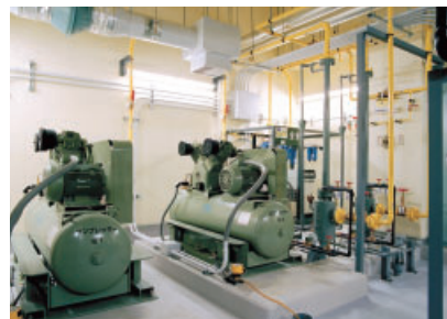
医療ガス供給システム（圧縮空気供給装置）
